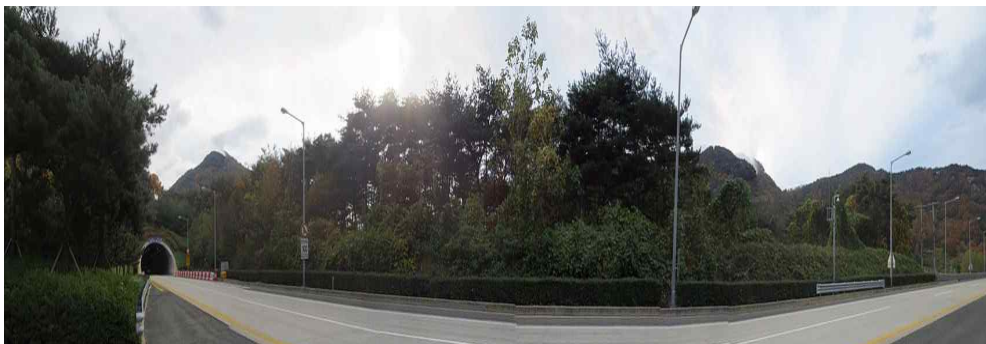
(중점부 절토사면 전경)
